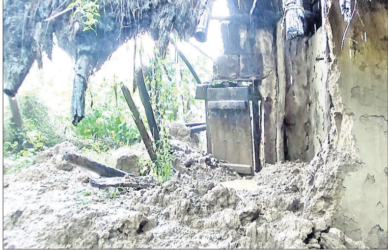
ଉଦକା ବୁକ ଅଞ୍ଚଳରେ ବର୍ଷା ହେବୁ ଏକ ଘର କାନ୍ଧ ଭାଙ୍ଗି ପଡ଼ିଛି।
